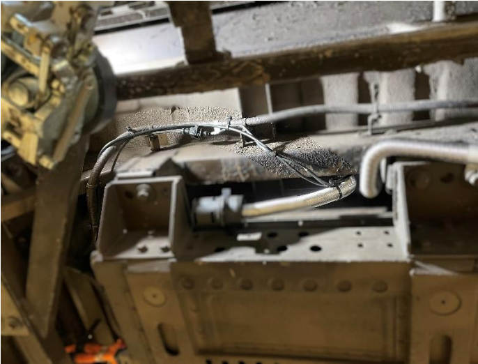
Led kablage mot bränslepump, längs original kabelstam.
